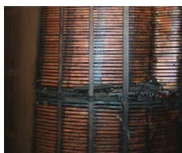
Поврежденная основная обмотка
